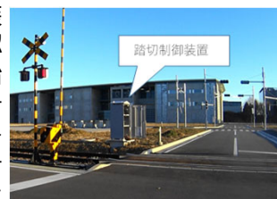
踏切制御装置
